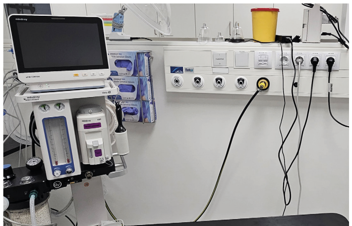
Med en centralgasanläggning minskar riskerna och därmed även stressen hos de anställda, eftersom behandlingsrummen är fria från gasflaskor.
