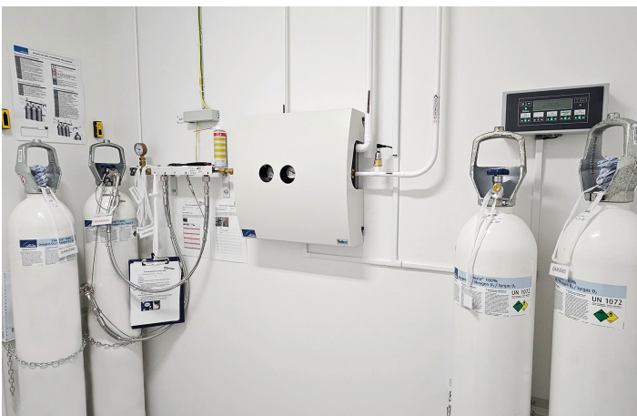
En centralgasanläggning har lång livslängd och installationen inkluderar personalutbildning.
